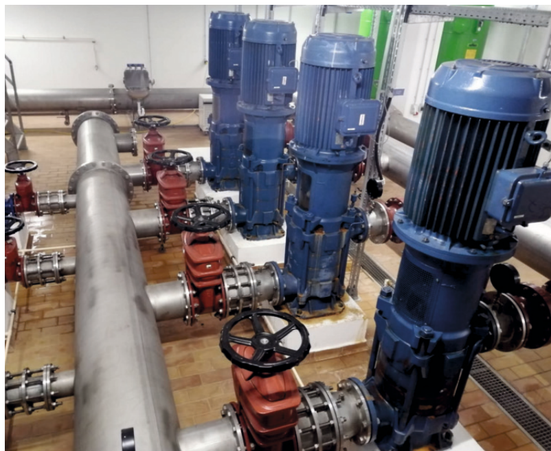
Die Druckerhöhungsanlage Großenhain-West vor dem Umbau.
