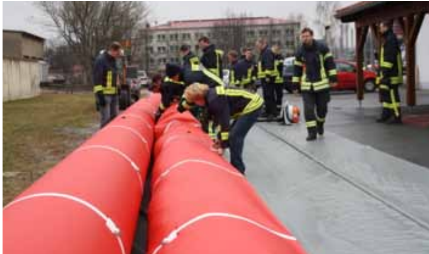
Übung der FFW und der Wasserwehr mit dem mobilen Schlauchsystem 2015
